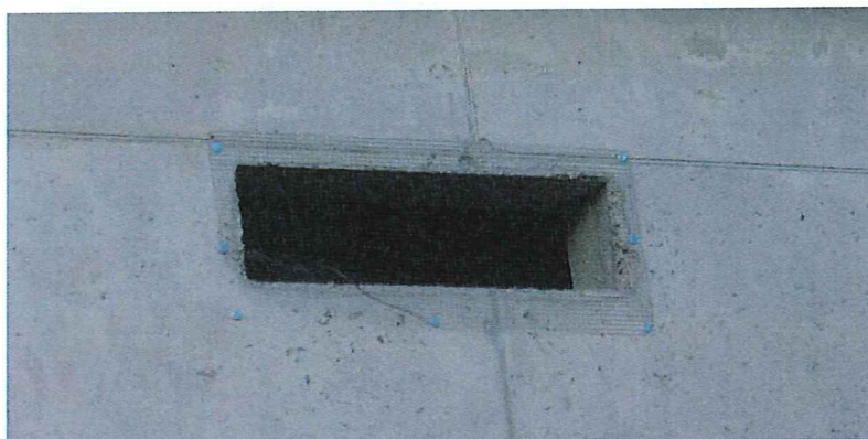
Fot. 6. Strona południowa – otwór 5 – siatka uszkodzona, odgięta lewa dolna krawędź
