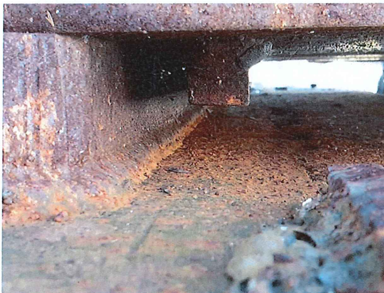
Fot. 16. łożysko południowe oczepu górnego przed konserwacją
