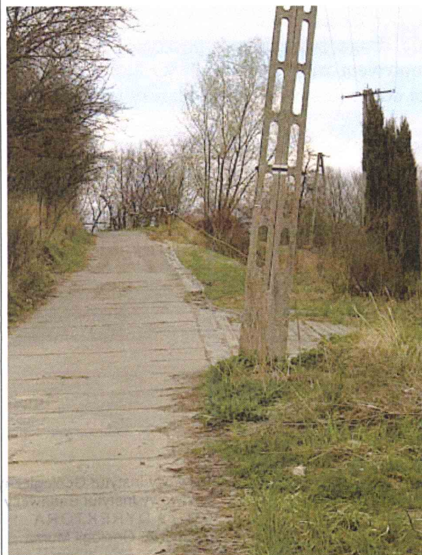
Fot.1. Droga i linia energetyczna w obrębie osuwiska.
