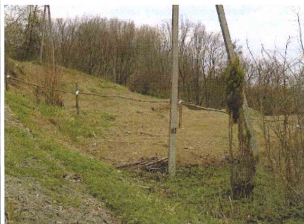
Fot.3. Północny skraj osuwiska
