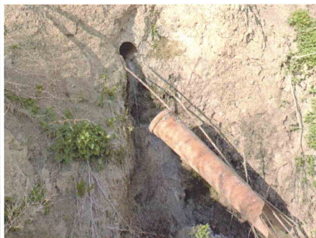
Fot.5. Rura kanalizacyjna odprowadzająca ścieki do osuwiska
